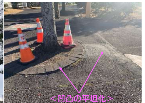
④ひだまり公園入口：根上がりによる凹凸の平坦化
