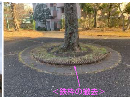
⑥パークサイド入口：根上がりによる凹凸の平坦化
